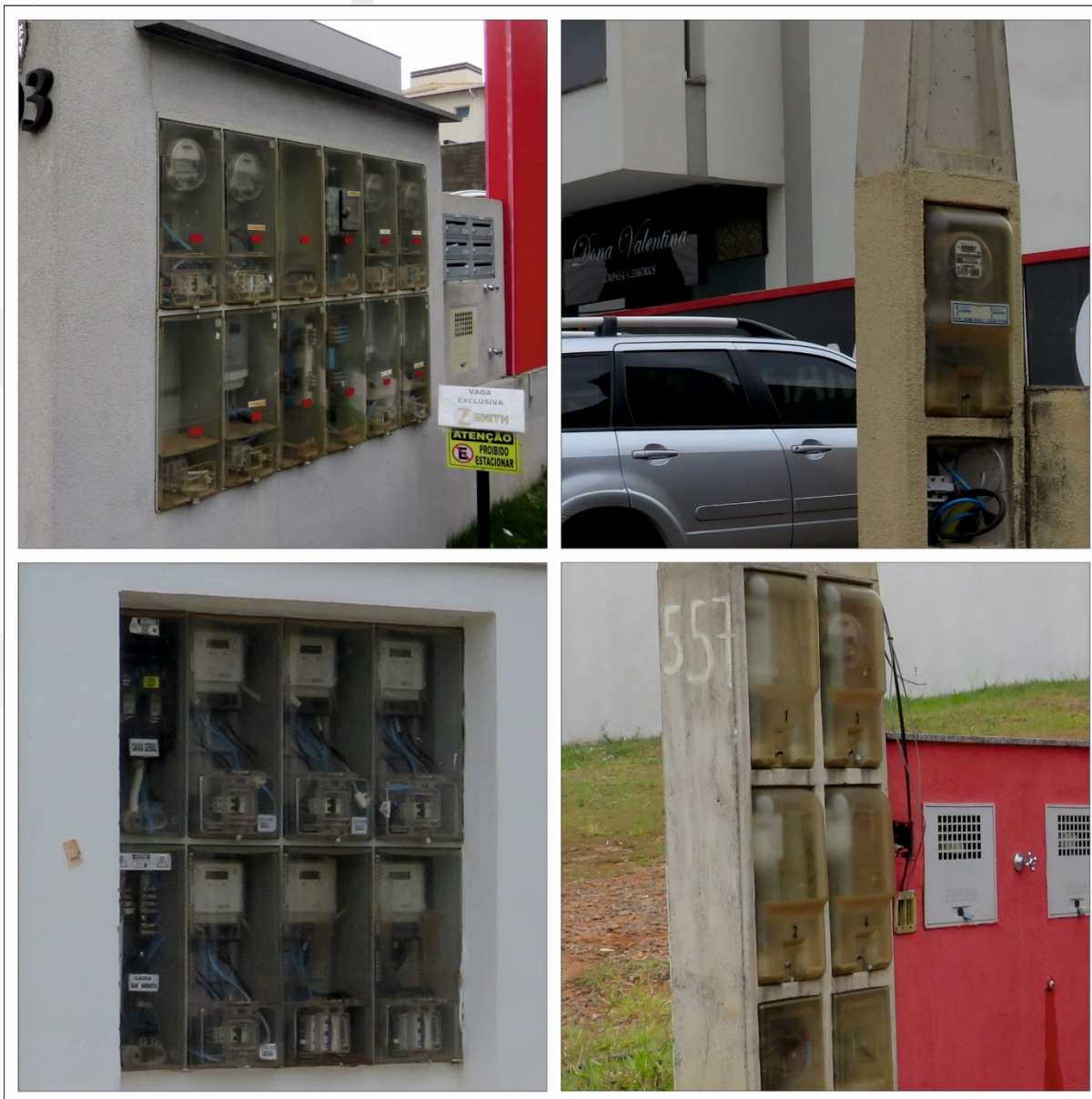
Figura 24. Fotografias – Equipamentos medidores de energia elétrica.
