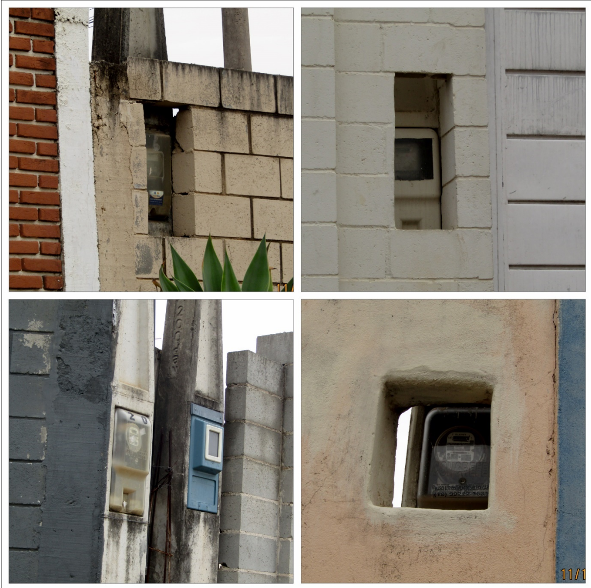
Figura 30. Fotografias – medidores de energia elétrica.
