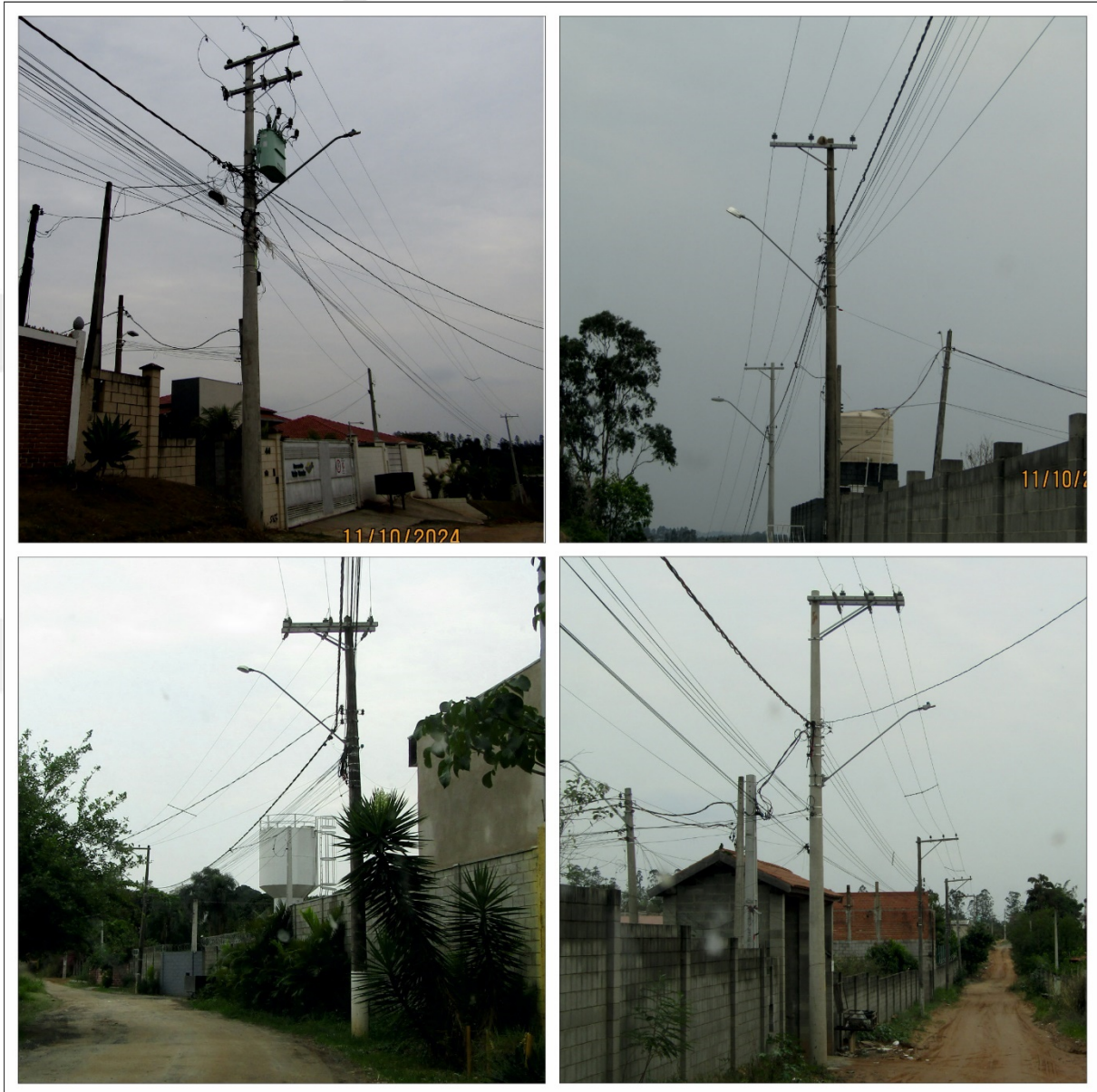
Figura 31. Fotografias – postes de iluminação pública. Fonte: Elaborado por Global Vias.
