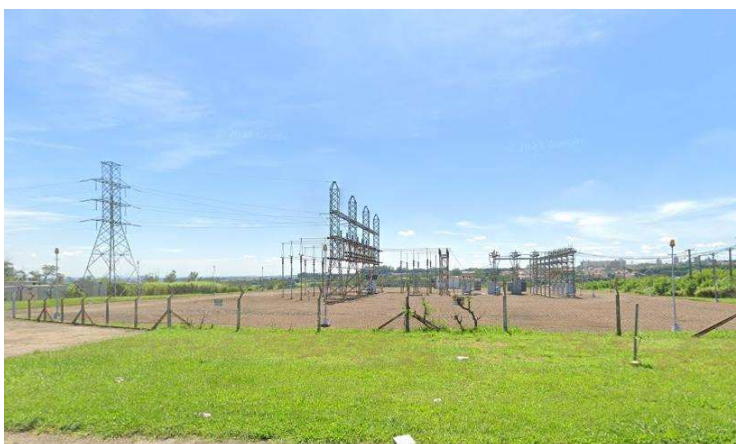
Figura 12: Subestação Chapadão (CPD)
