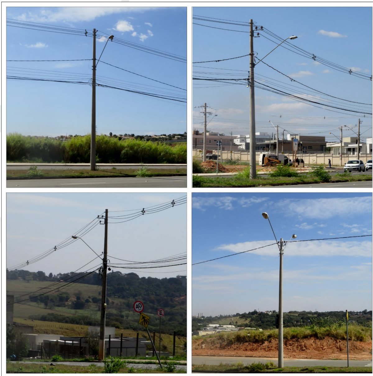
Figura 30. Fotografias – Postes de iluminação pública Elaborado por Global Vias.
