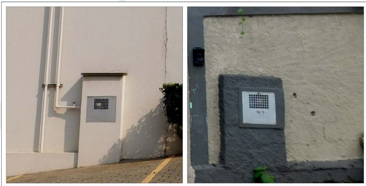
Figura 28. Fotografias – Equipamentos medidores das redes de água e esgoto. Elaborado por Global Vias.
