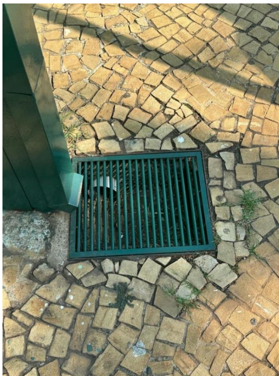
Figura 20 Sistema de Drenagem Pública Existente na Rua 24 de Maio.
