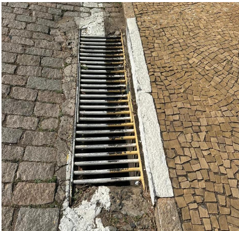
Figura 22 Sistema de Drenagem Pública Existente na Rua 24 de Maio.
