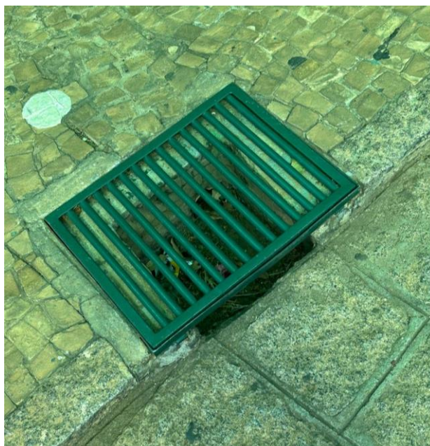
Figura 21 Sistema de Drenagem Pública Existente na Rua 24 de Maio.
