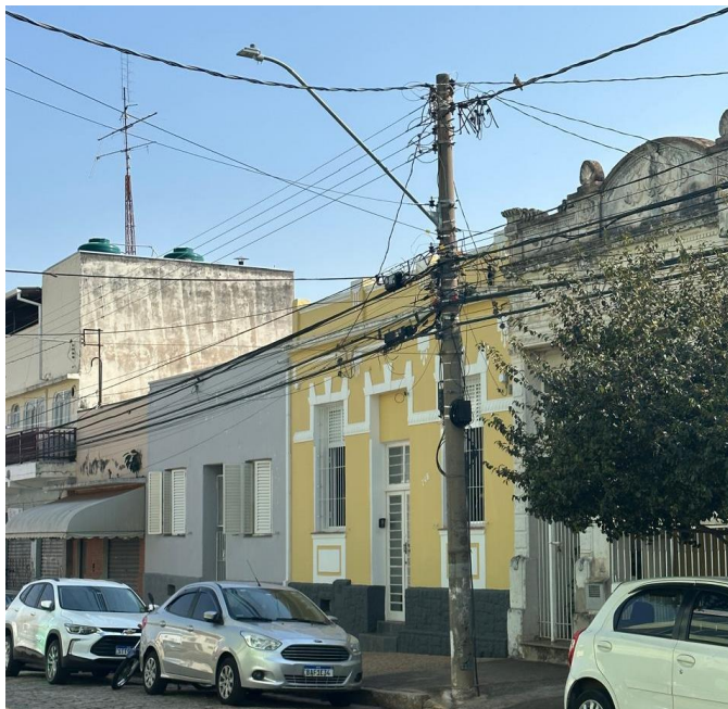
Figura 16 Iluminação Pública Existente na Rua 24 de Maio
