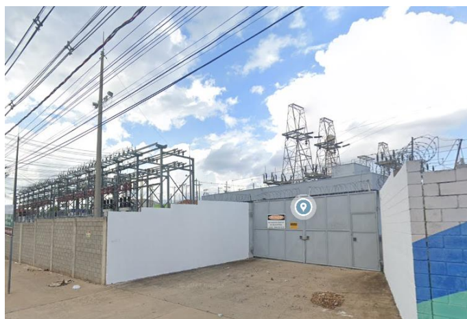
Figura 12: Subestação Trevo (TRE)
