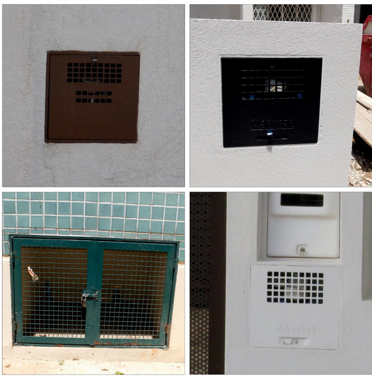
Figura 17. Fotografias – Equipamentos medidores das redes de água e esgoto Fonte: Elaborado por Global Vias.
