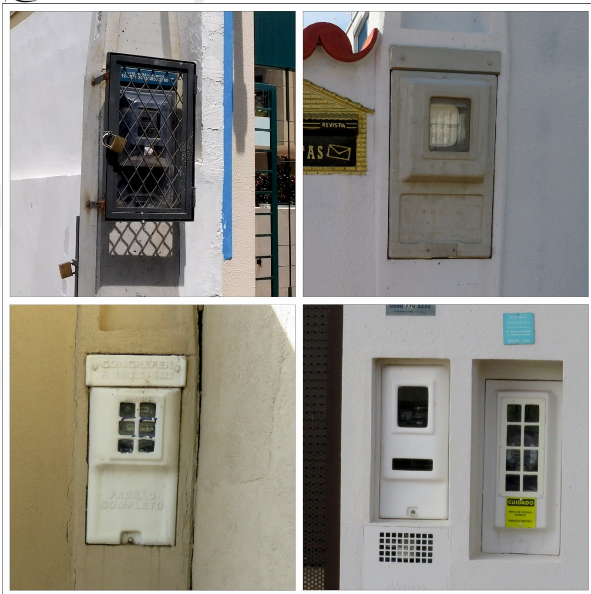
Figura 18. Fotografias – Equipamentos medidores de energia elétrica.
