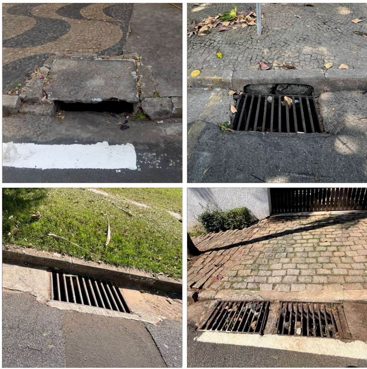
Figura 20. Fotografias - Boca de lobo.
