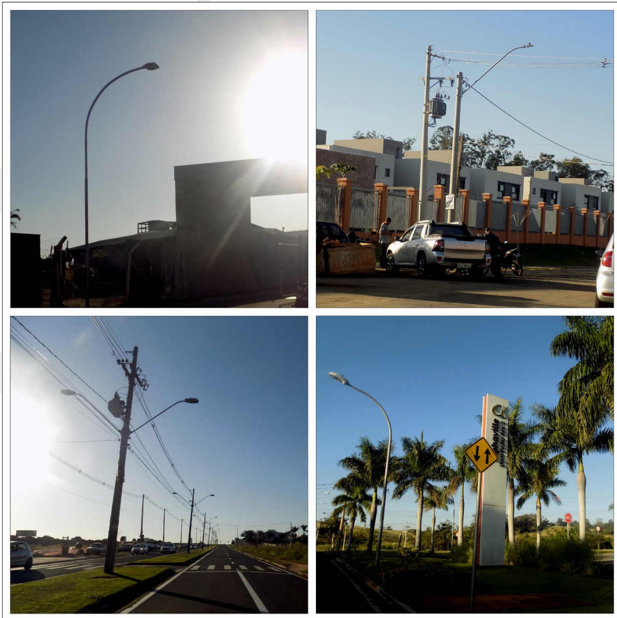
Figura 43. Fotografias – Postes de iluminação pública Fonte: Google Earth – Modificado por Global Vias.
