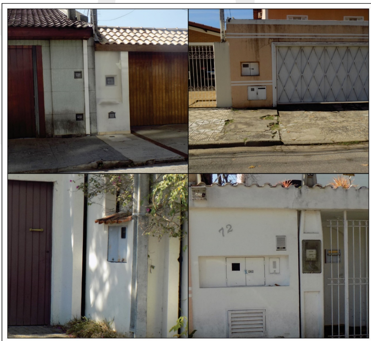
Figura 42. Fotografias – Equipamentos medidores de energia elétrica. Fonte: Elaborado por Global Vias.
