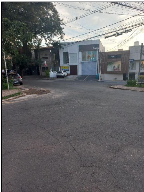
Foto 1. Rua General Osório (P3).
