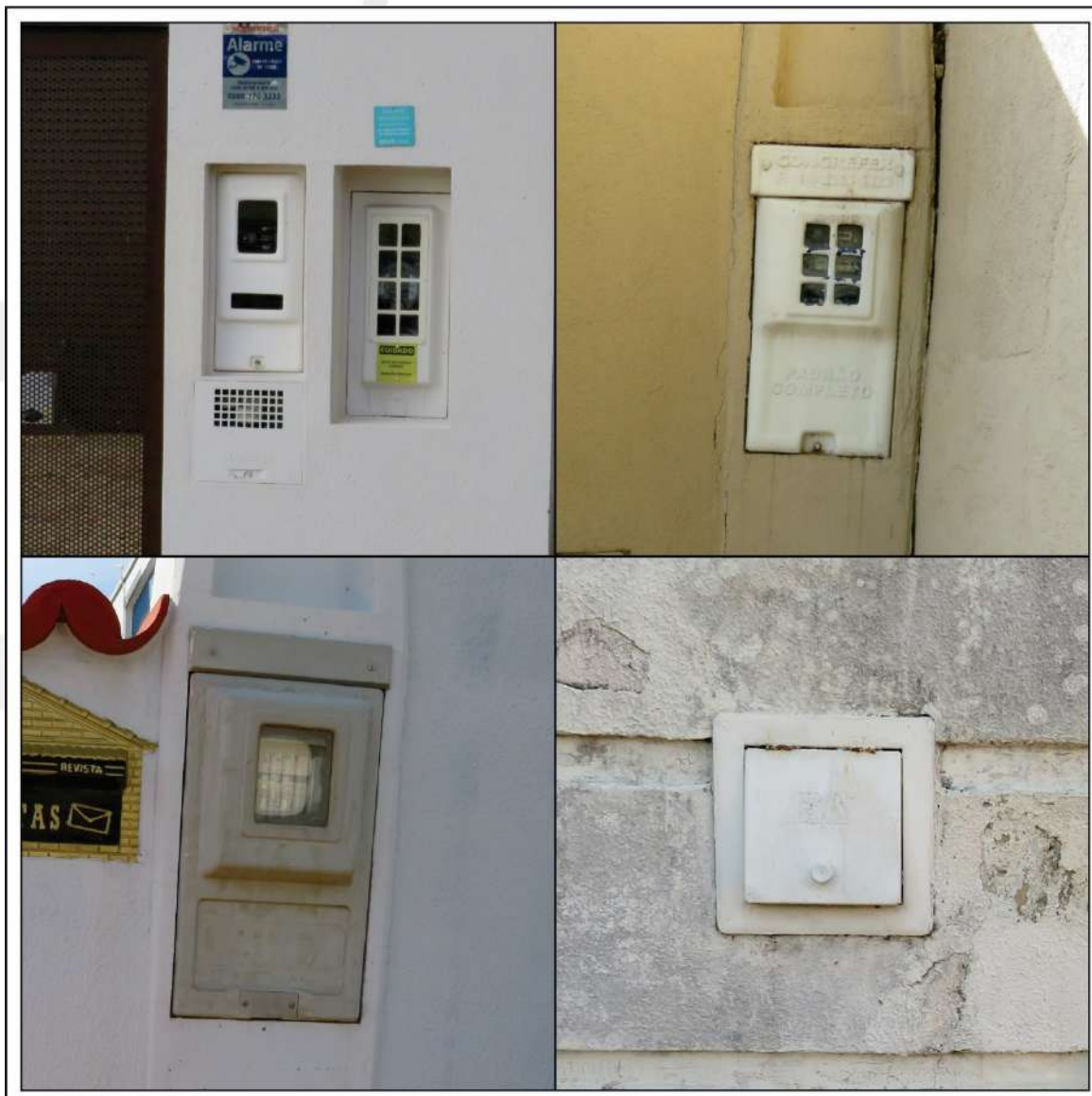
Figura 19. Fotografias – Equipamentos medidores de energia elétrica. Elaborado por Global Vias.
