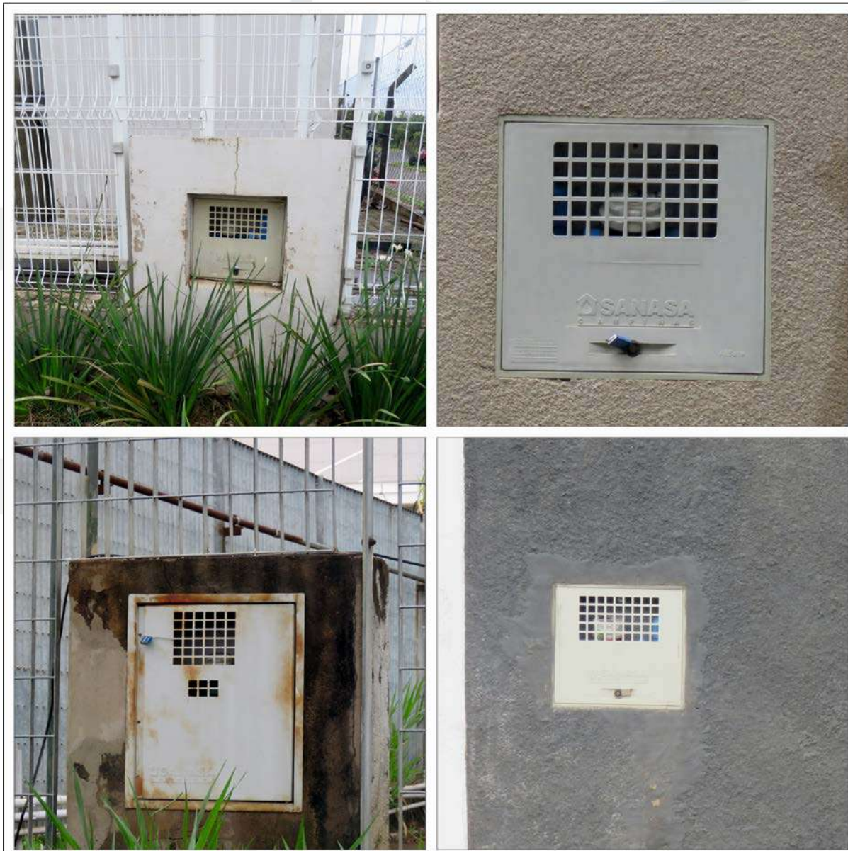
Figura 25. Fotografias – Equipamentos medidores das redes de água e esgoto. Elaborado por Global Vias.
