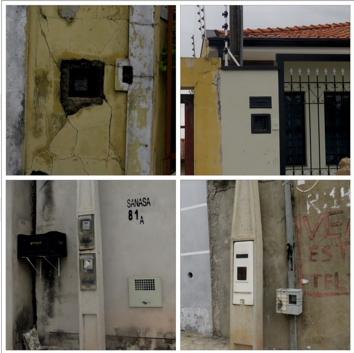
Figura 18. Fotografias – Equipamentos medidores de energia elétrica. Elaborado por Global Vias.
