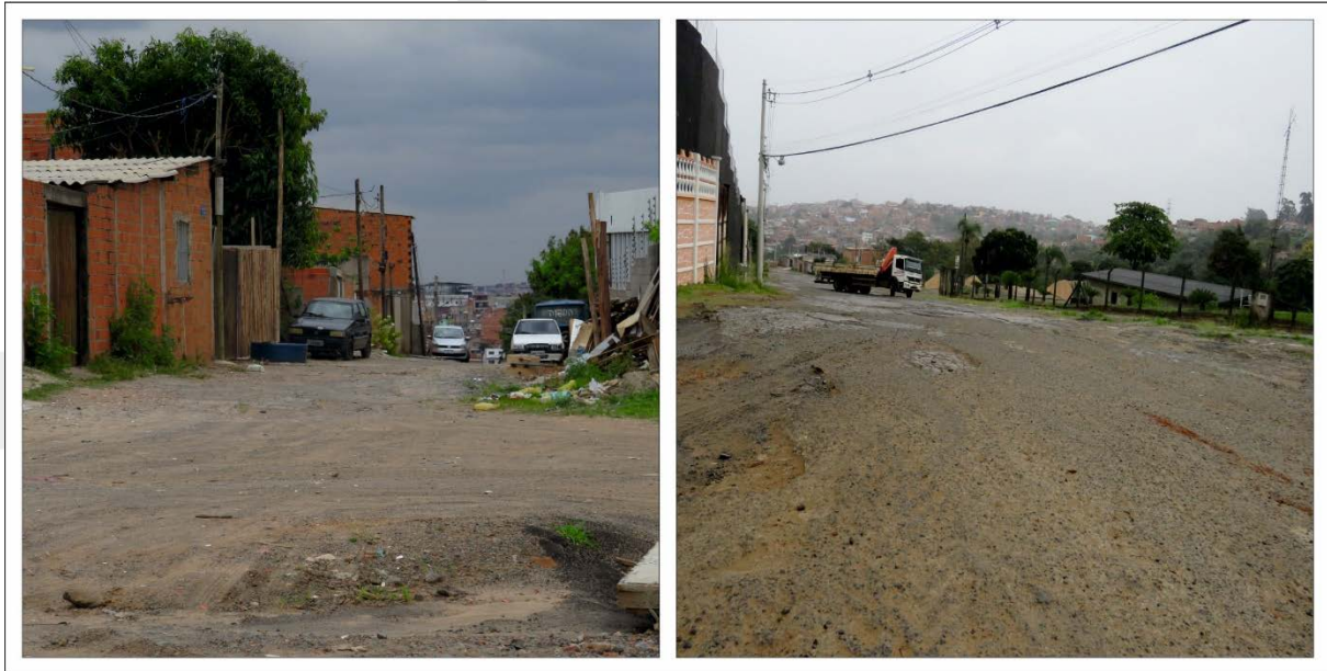
Figura 24. Fotografias – Vias na região sem pavimentação adequada Elaborado por Global Vias.
