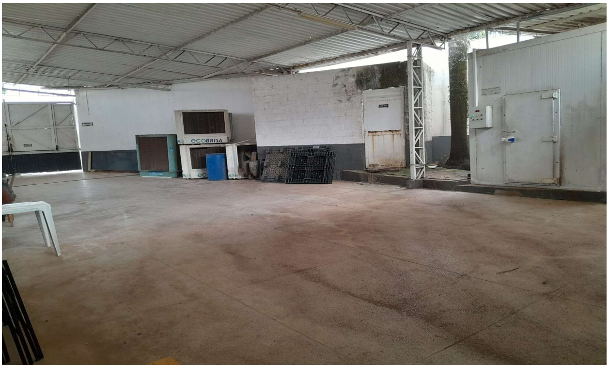
foto 35.A - espaço cozinha/ camara fria e casa do lixo
