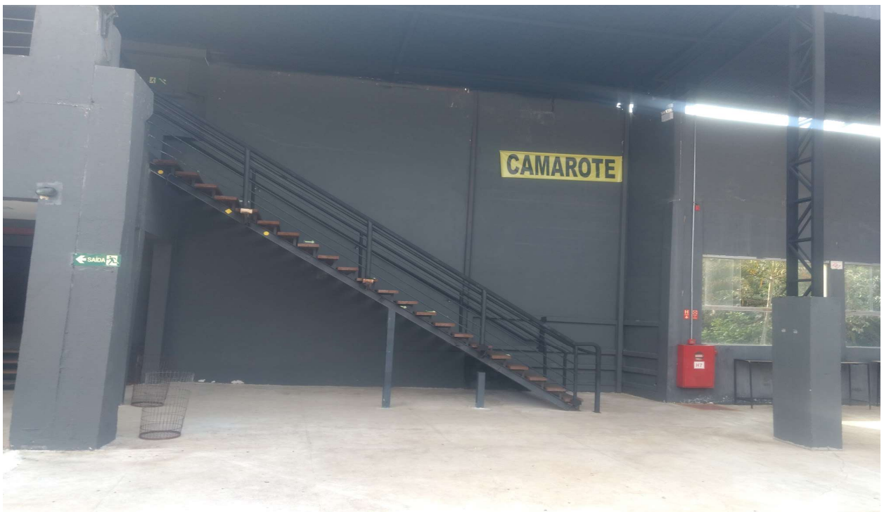
foto 28 - vista interna do salão descoberto olhando para escada de acesso ao piso superior
