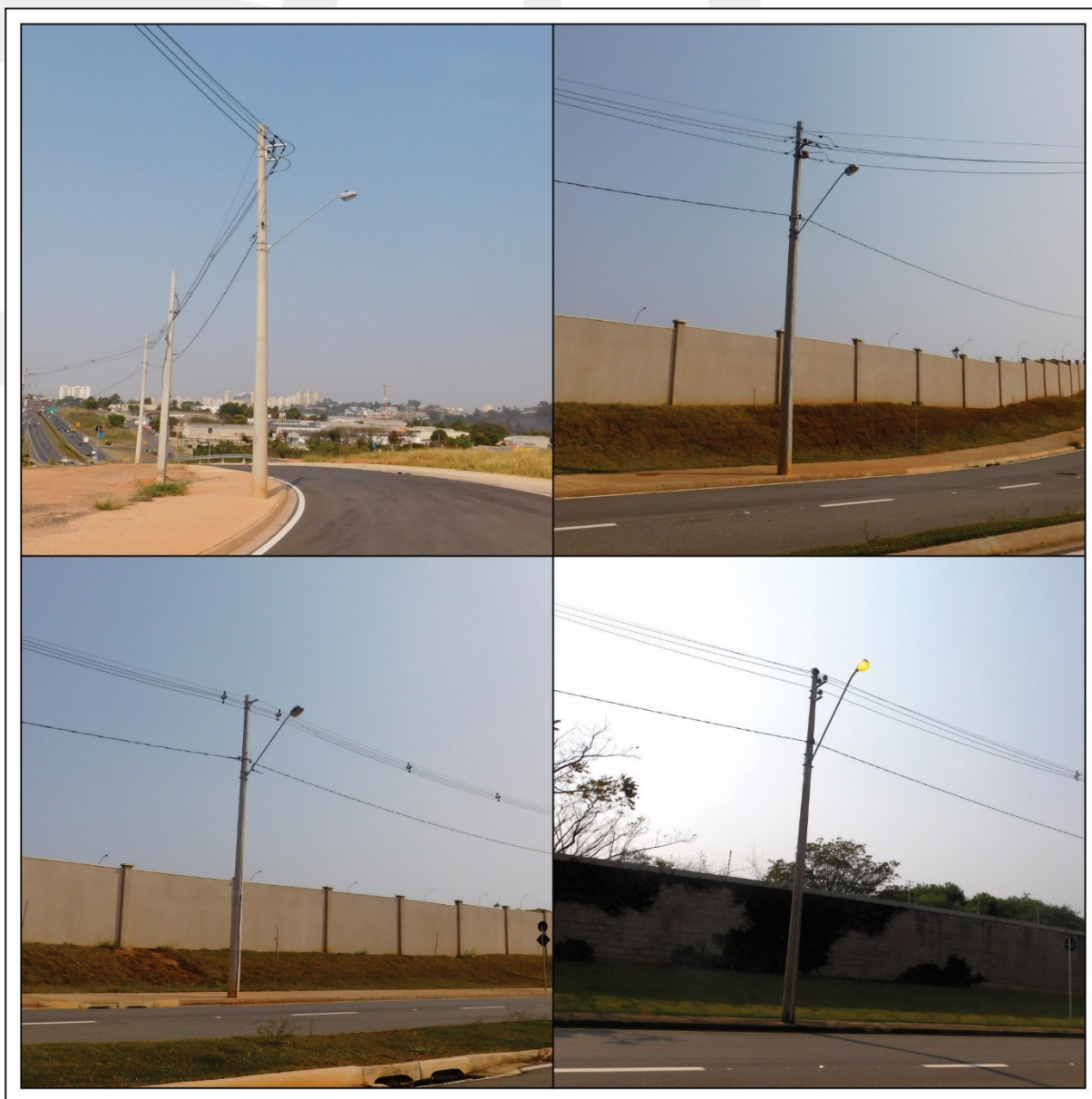
Figura 21. Fotografias – Postes de iluminação pública
