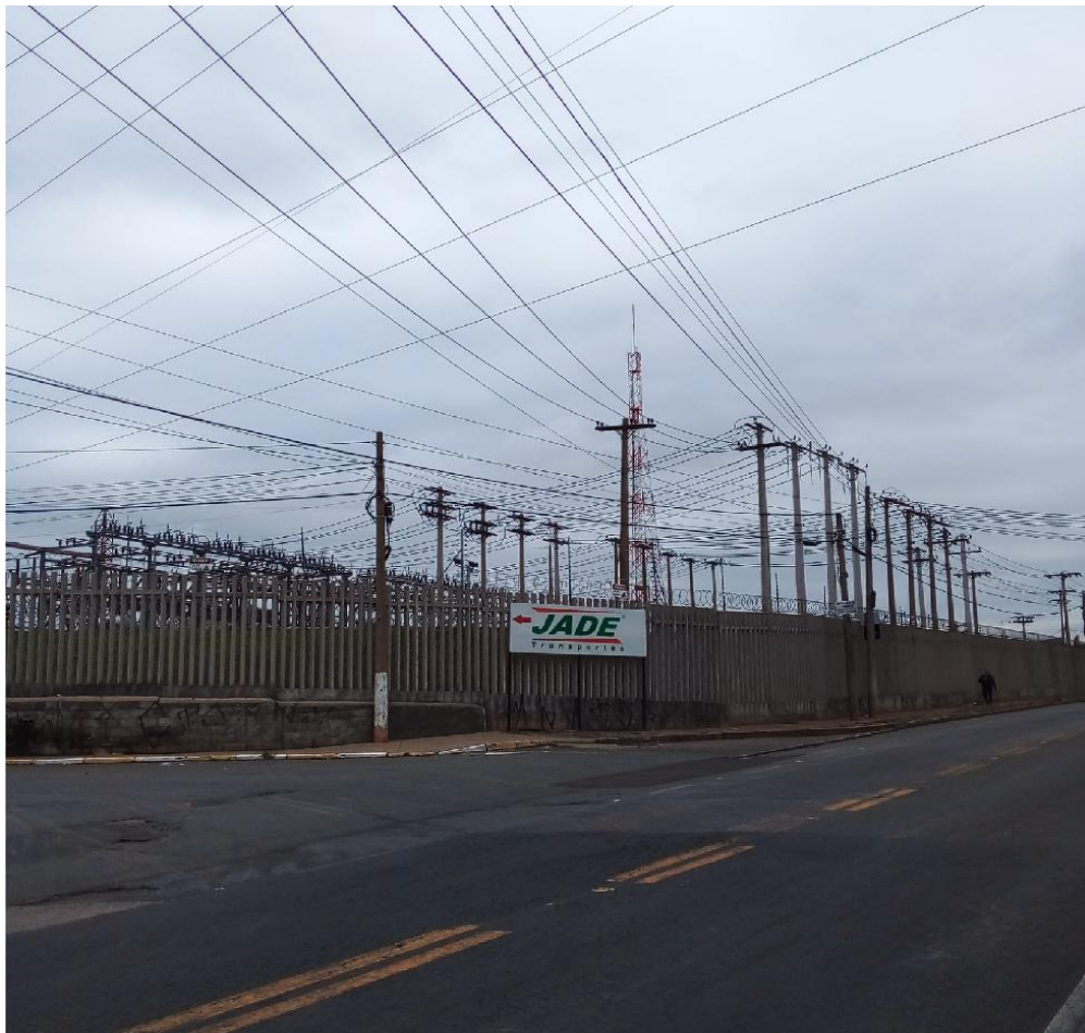
Figura 12: Subestação SE Viracopos.
