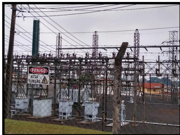
Foto 24: Vista para a subestação.
