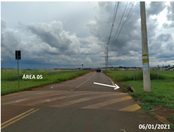
Foto 4: Sistema de drenagem pública, indicado pela seta, existente na Estrada Municipal (continuação da Rua Honório Chiminazo).
