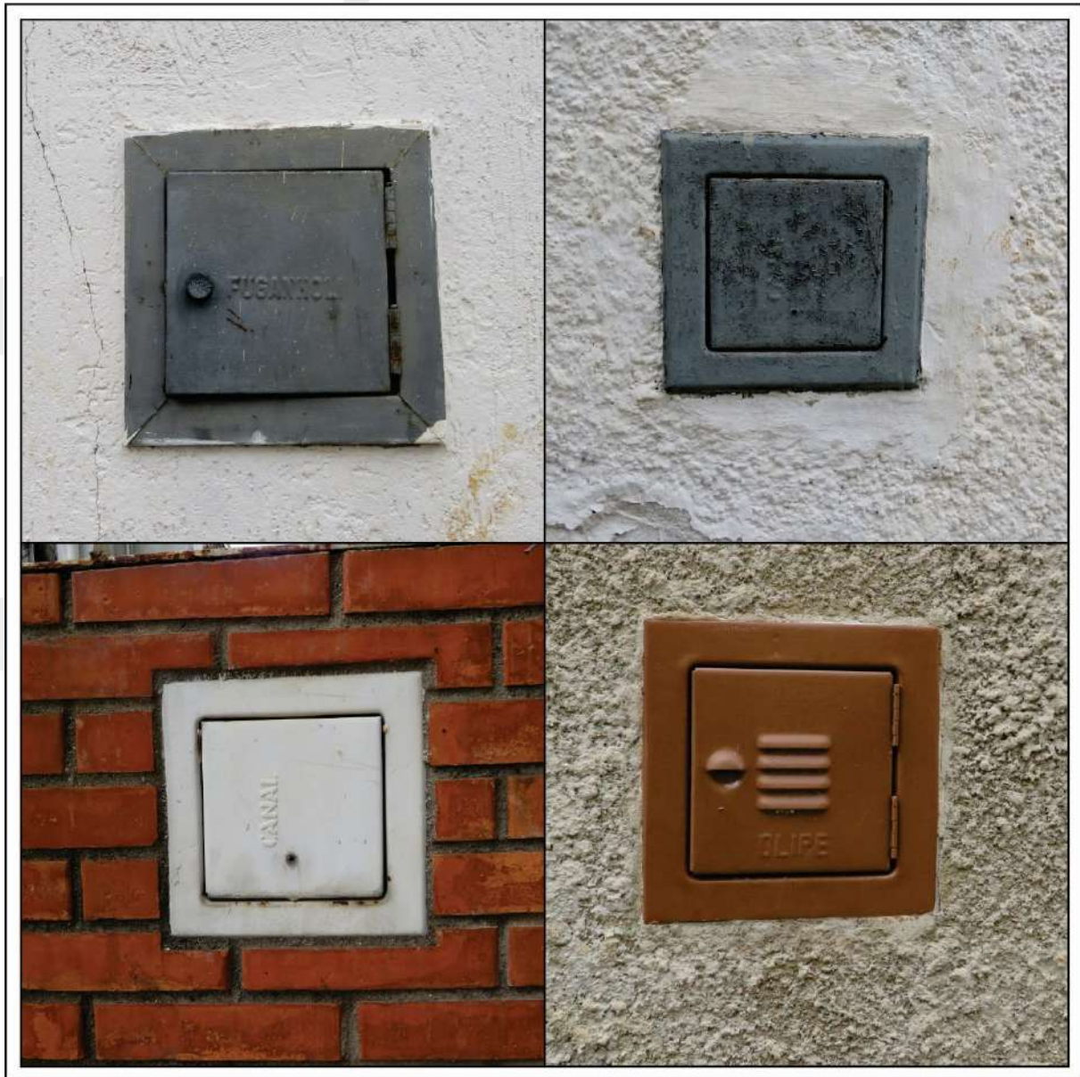
Figura 20. Fotografias – Equipamentos medidores de energia elétrica. Elaborado por Global Vias.
