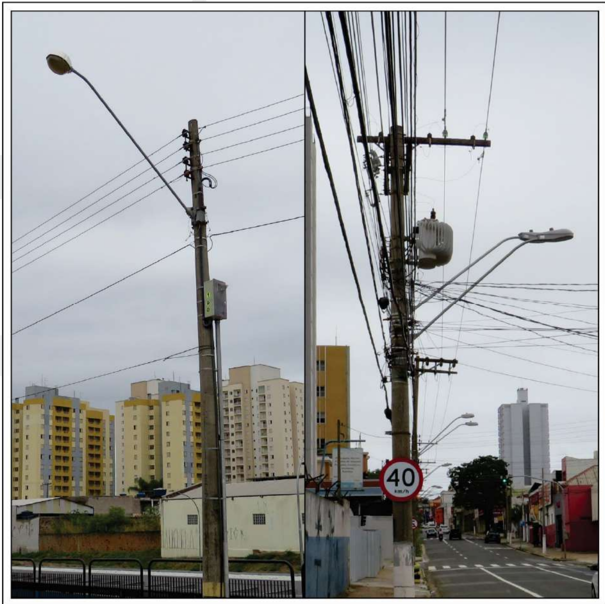
Figura 21. Fotografias – Postes de iluminação pública Elaborado por Global Vias.
