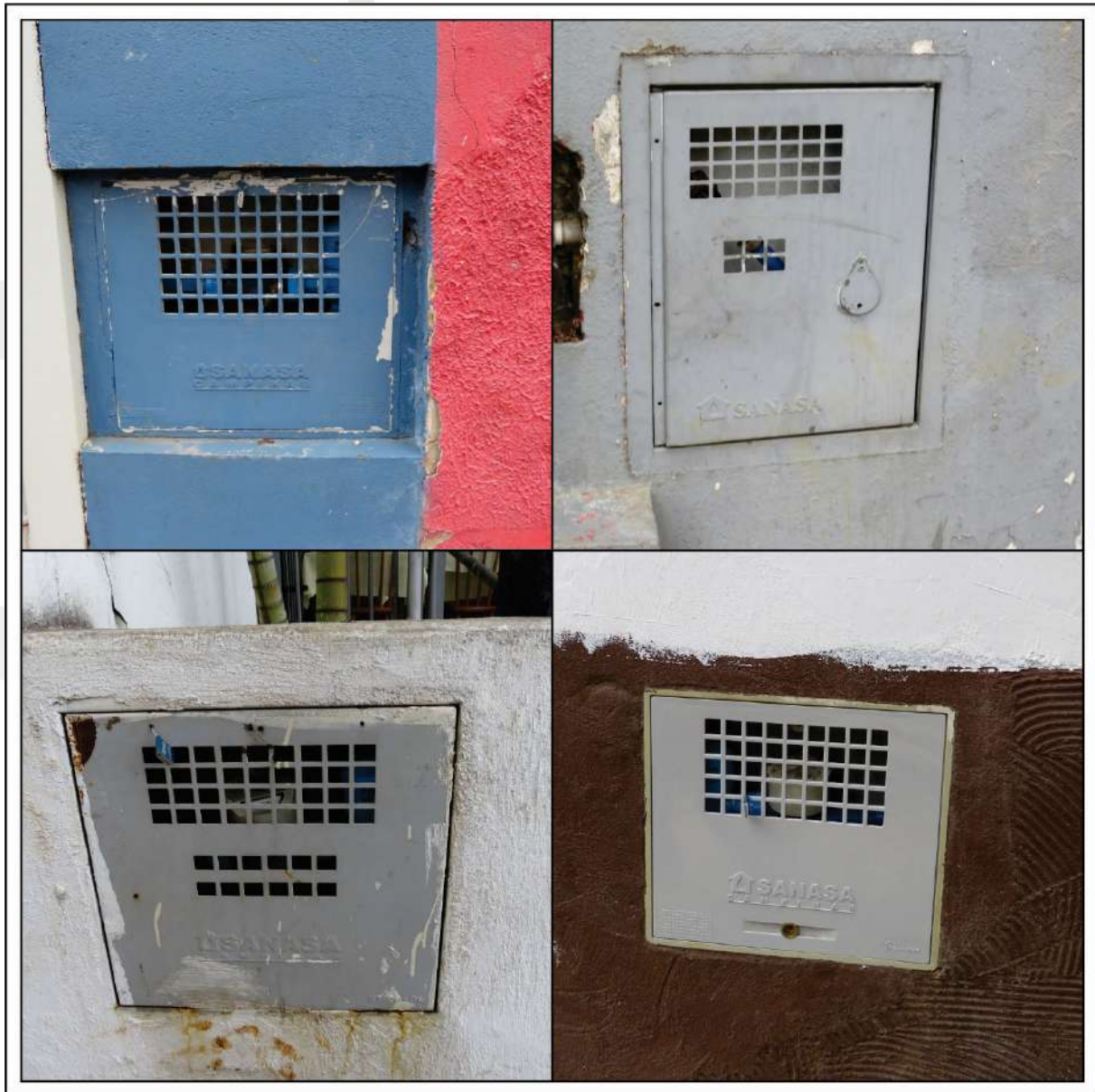
Figura 19. Fotografias – Equipamentos medidores das redes de água e esgoto Elaborado por Global Vias.
