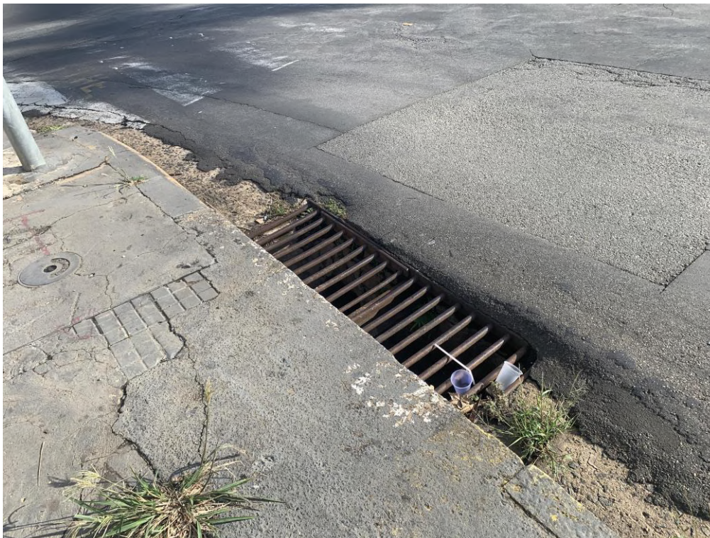
Figura 34. Boca de lobo na Rua Barão de Parnaíba.
