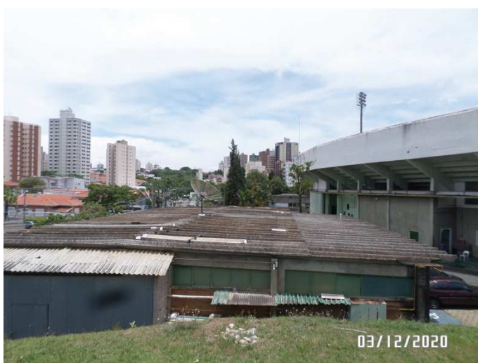
Foto 5. Vista de edificação (telhado) e arquibancada a serem demolidos na porção sul do empreendimento.
