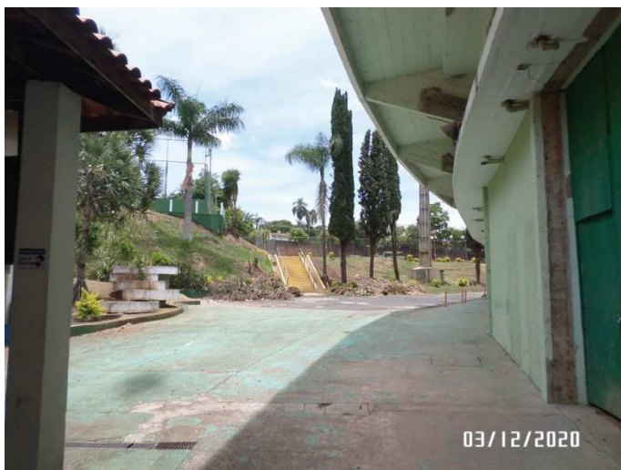
Foto 7. Vista da marquise da arquibancada a ser demolida na porção oeste do terreno.
