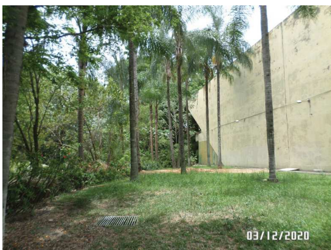
Foto 9. Vista de parede de edificação a ser demolida na porção norte do terreno.
