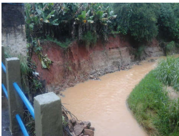
Desbarrancamento de córrego.
