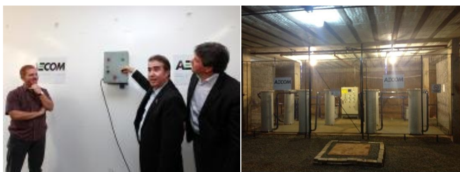
Representante da AECOM, Prefeito e Secretário do Verde acionam sistema de drenagem de gases.
