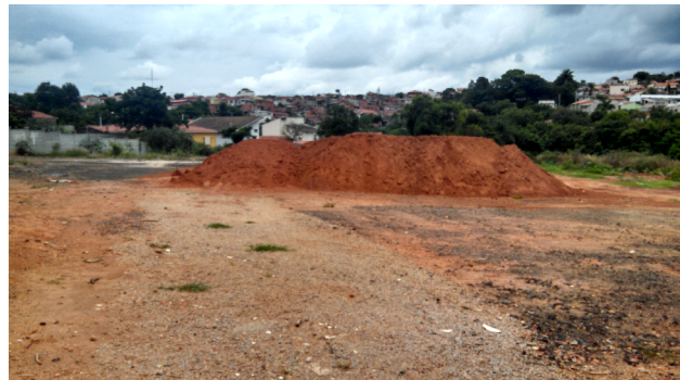
Vistoria em movimentações de terra irregulares
