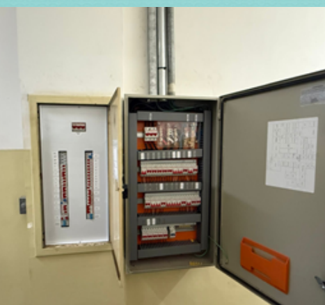
Novo Quadro de Energia
