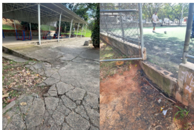
Figura 42: Pisos quebrados e dificuldade de acesso ao campo society .
