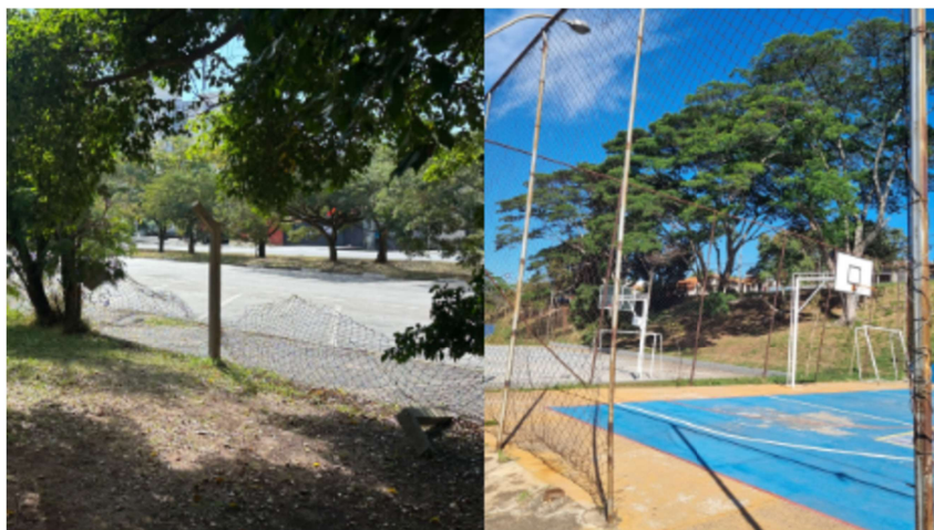
Figura 40: Alambrado externo e interno danificados.
