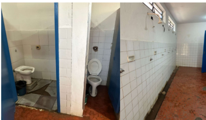
Figura 41: Banheiros danificados e sem chuveiros.
