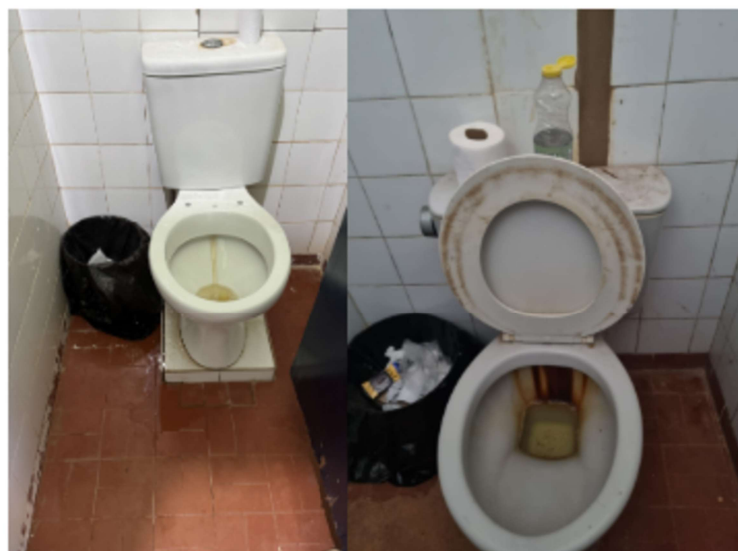
Figura 37: Vastos sanitários sem higienização.
