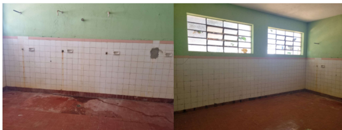
Figura 36: Banheiros sujos e deteriorados.
