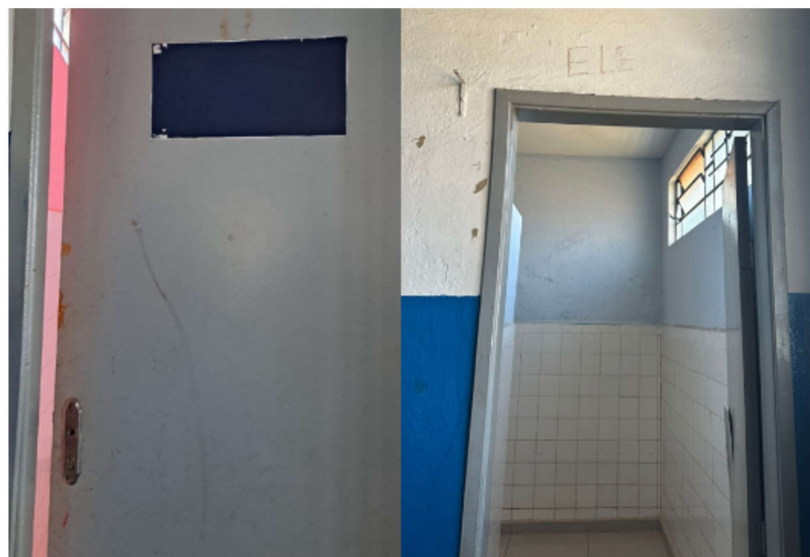
Figura 23: Sanitários sem maçaneta e identificação.
