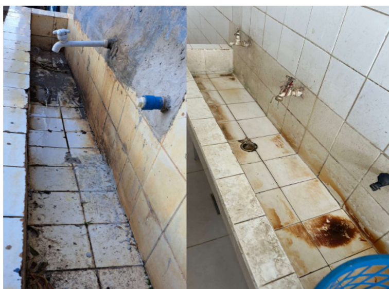
Figura 21: Pia externa e interna em condições precárias.
