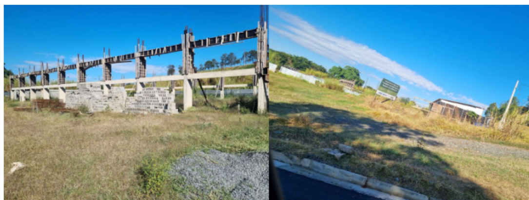
Figura 46: Obra inacabada - Quadra de Badminton .
