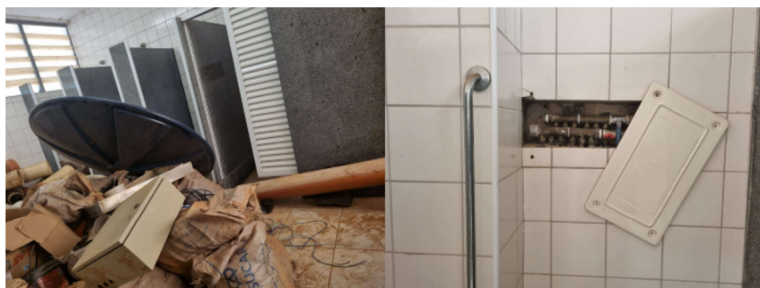
Figura 49: Entulhos e registro exposto - Complexo Aquático.
