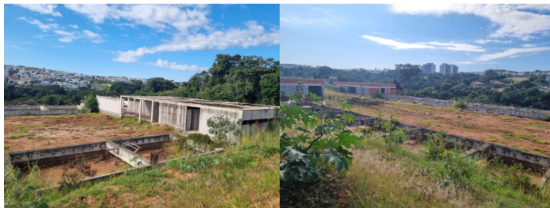
Figura 45: Obra inacabada - Complexo de Quadras.
