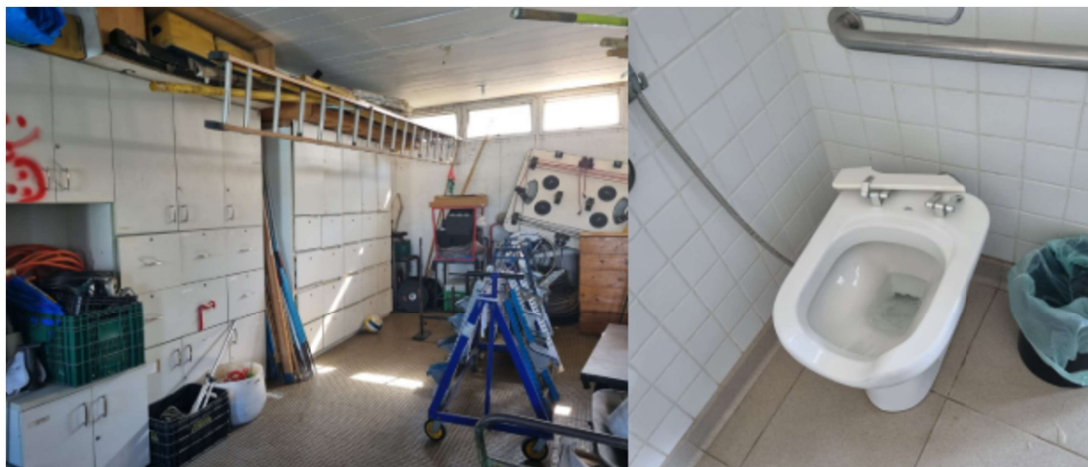
Figura 53: Almoxarifado e banheiro PcD quebrado - Complexo Atletismo.
