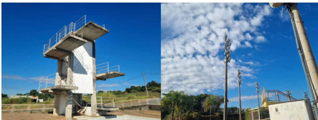
Figura 50: Piscina e refletores inoperantes - Complexo Aquático.
