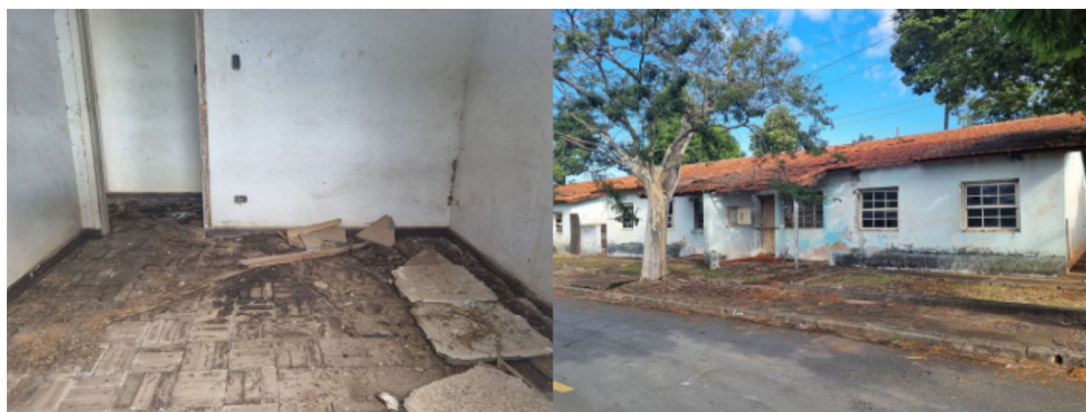
Figura 47: Alojamento dos atletas deteriorados.
