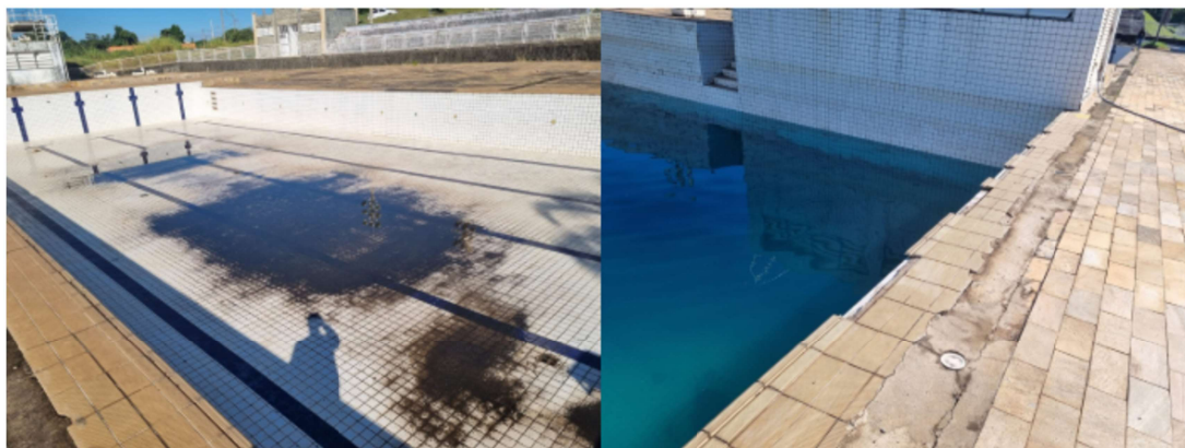
Figura 51: Piscina desativada e bordas quebradas - Complexo Aquático.
