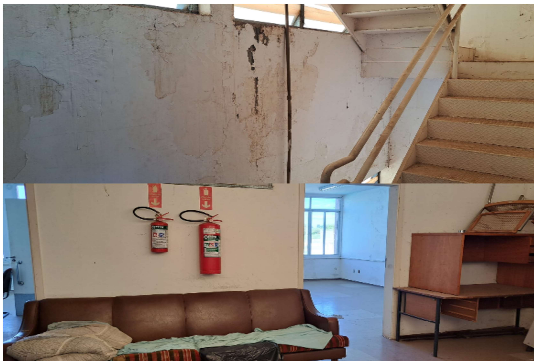
Figura 52: Área administrativa sem devida manutenção - Complexo Aquático.
