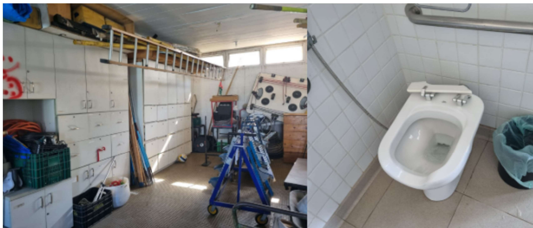
Figura 53: Almojarifado e banheiro PcD quebrado - Complexo Atletismo.
