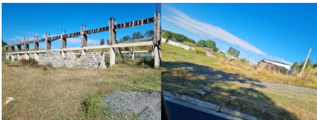
Figura 46: Obra inacabada - Quadra de Badminton .
