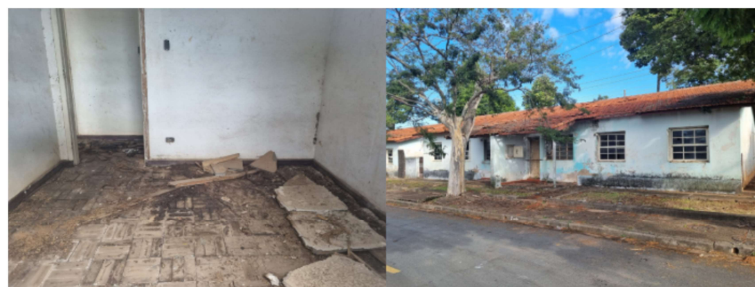
Figura 47: Alojamento dos atletas deteriorados.
