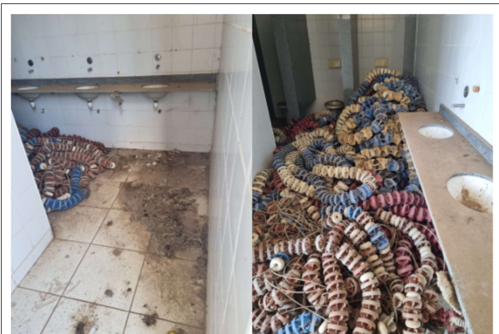
Figura 48: Vestiários e banheiros degradados - Complexo Aquático.
