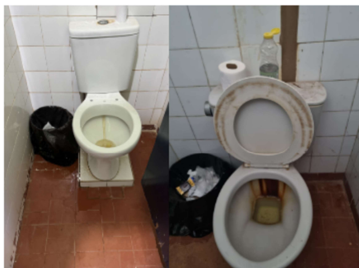
Figura 37: Vastos sanitários sem higienização.
