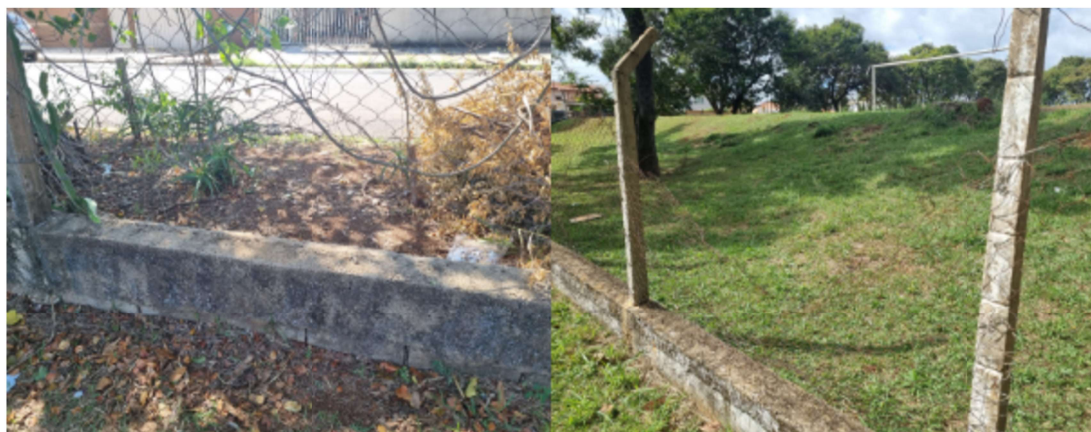
Figura 34: Alambrado interno e externo danificados.
