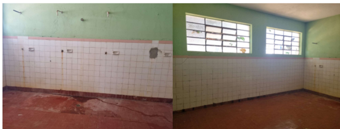
Figura 36: Banheiros sujos e deteriorados.
