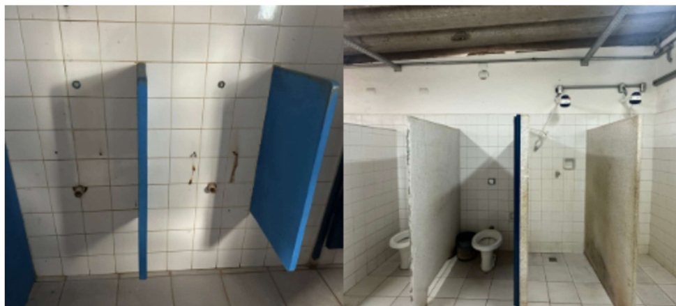
Figura 30: Ausência de mictórios e vasos sanitários quebrados.
