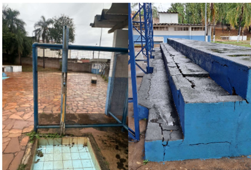
Figura 31: Área da piscina degradada e arquibancada quebrada.
