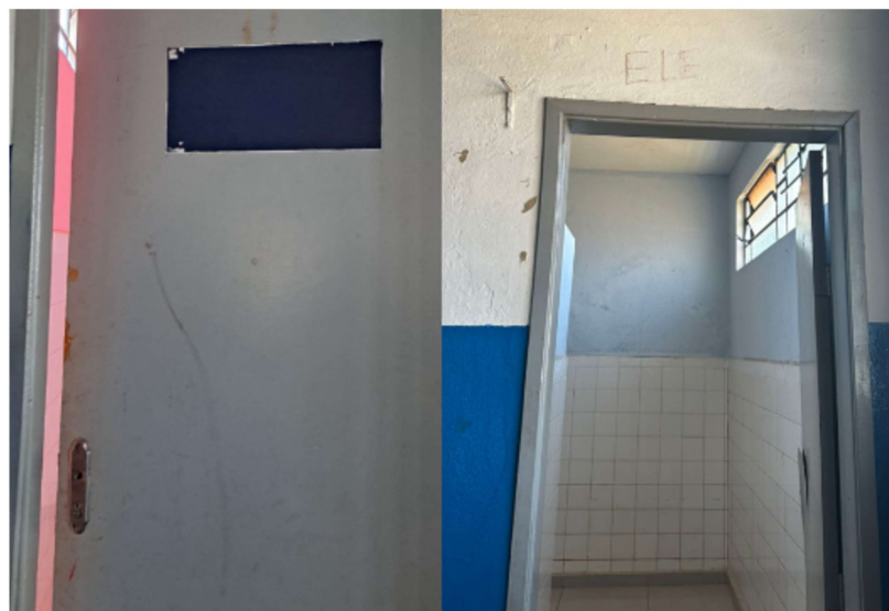
Figura 23: Sanitários sem maçaneta e identificação.
