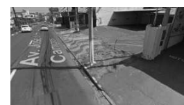
Av. José de S. Campos (Subtrecho um – Calçada esburacada) Fonte: Google Street View (2015)
