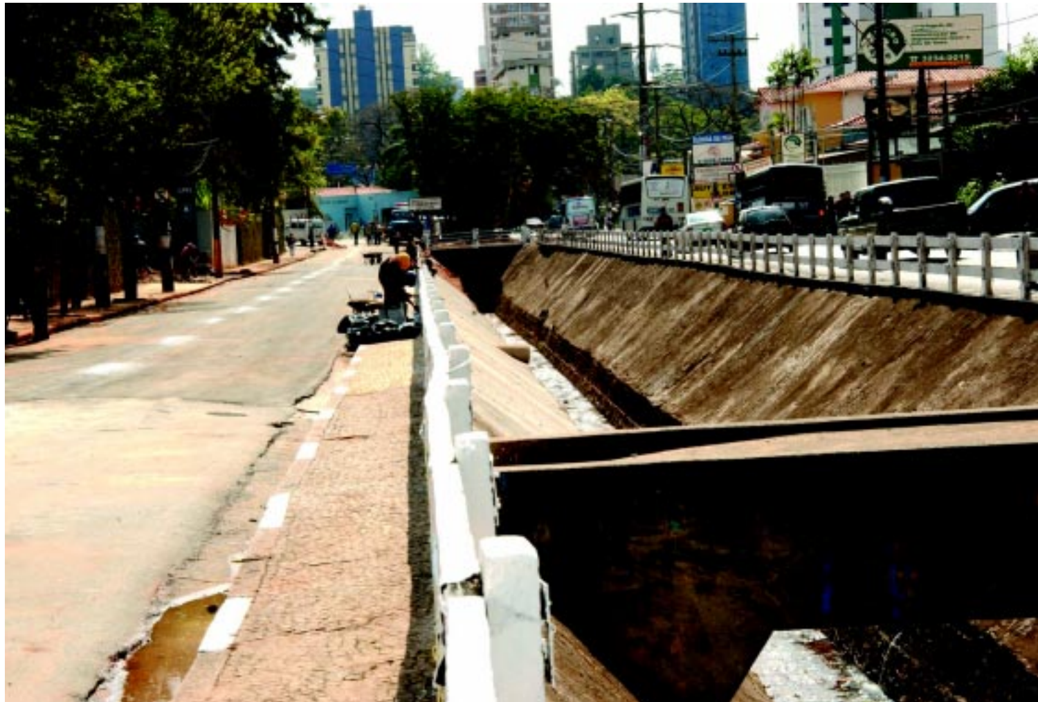
Canalização de concreto do telto havia desabado com temporais de fevereiro: reformas foram feitas nos últimos 90 dias
