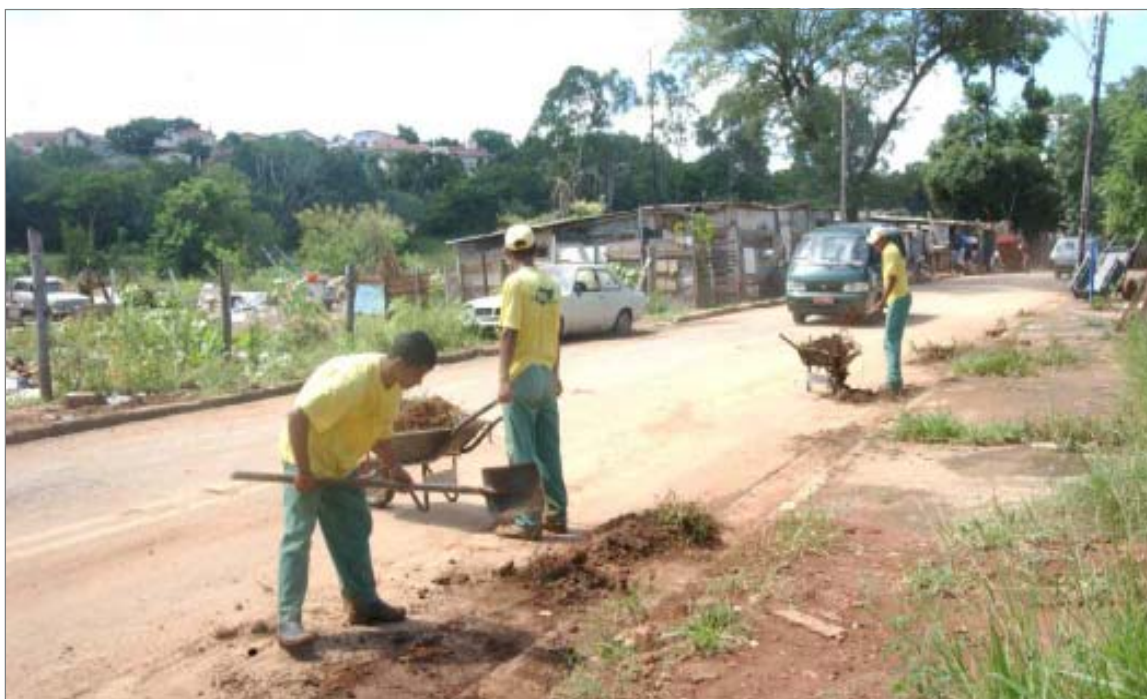
Remoção de lama e entulho na região da Rua Moscou, uma das áreas mais atingidas pelas chuvas
