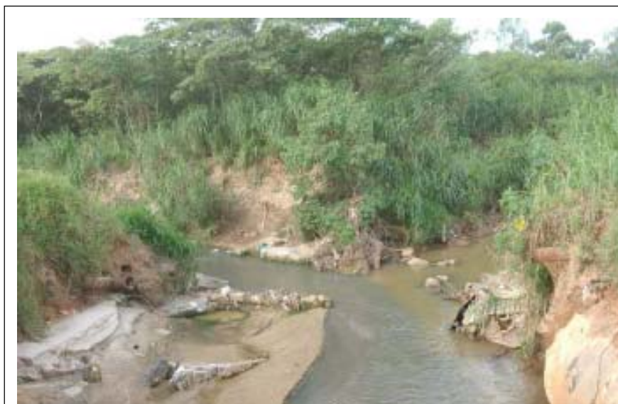
Ponte destruída pela chuva de fevereiro na região do Jardim Capivari
