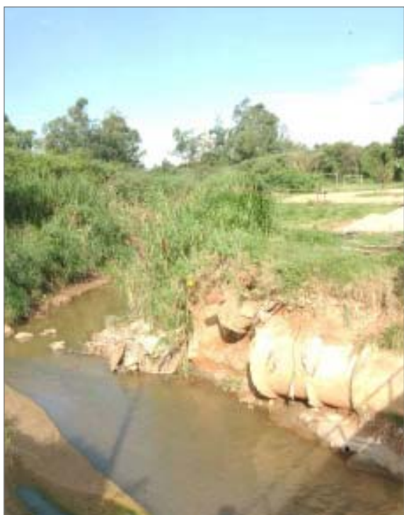
Ponte destruída pelas chuvas no Jardim Capivari
