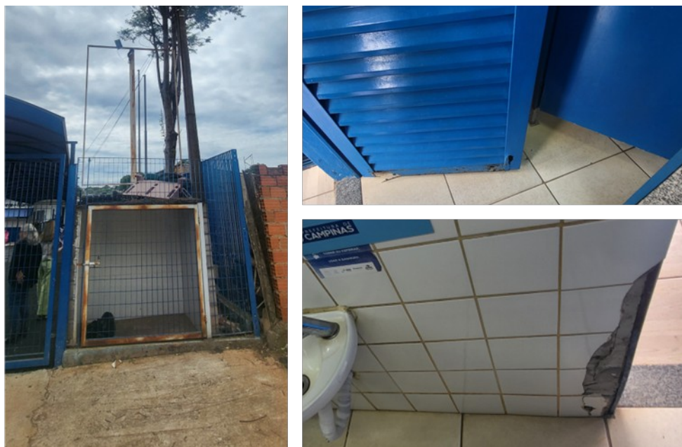
Figura 11: CEI Sossego da Mamãe - Ausência de placa de identificação; ladrilhos quebrados; portas enferrujada (do banheiro e do setor separado para lixos).
