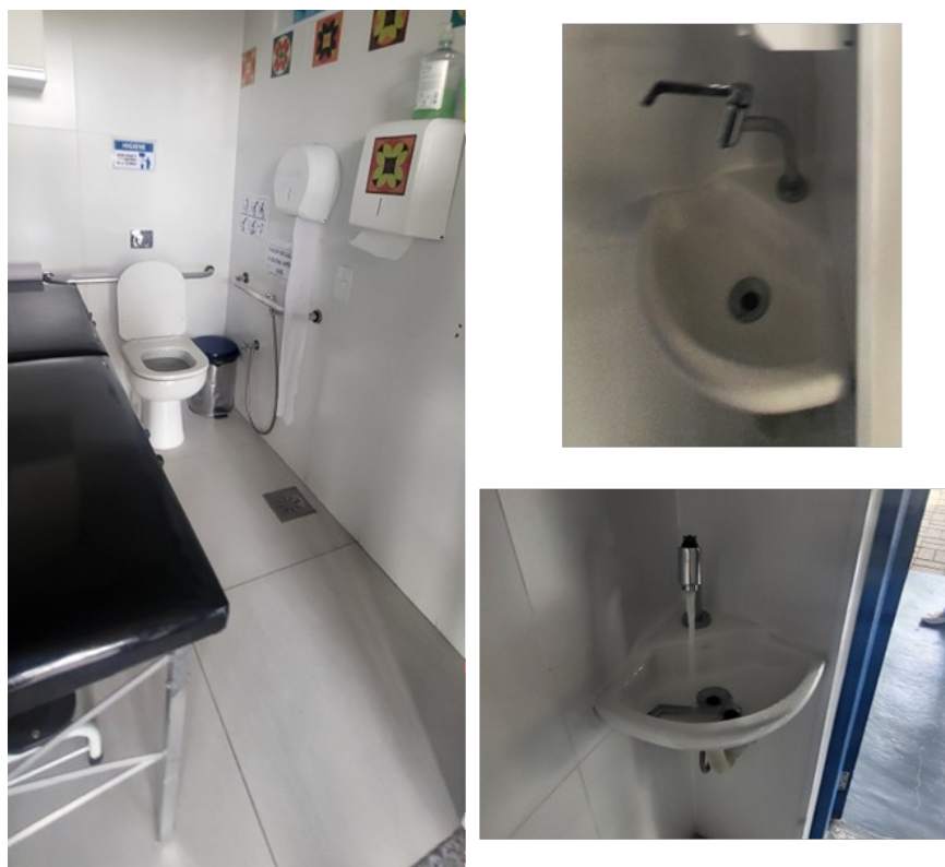
Figura 4: EMEF - Maria Luiza Pompeo de Camargo - Banheiro de PCD com boa infraestrutura, mas com a torneira danificada.
