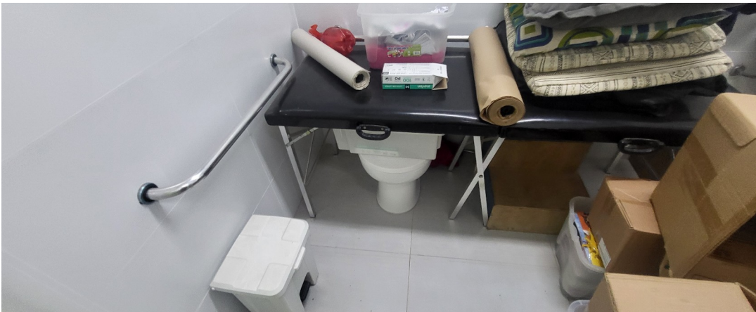
Figura 2: CEI Casinha Feliz - Banheiro acessível obstruído.
