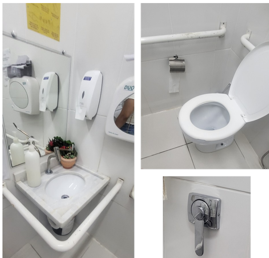
Figura 3: CEI São Francisco de Assis - Banheiro para PCD com barras enferrujadas e descarga não funcional.
